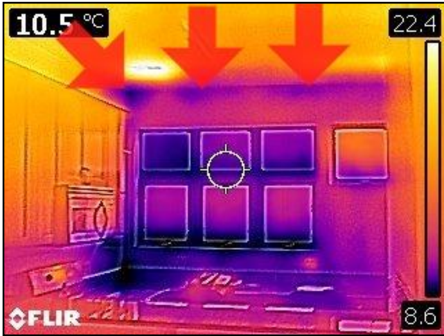
18. Moisture in wall
